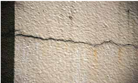
写真 - 7 処理槽躯体での水平クラック
