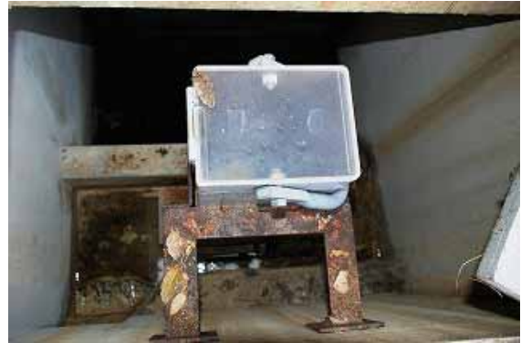
写真 - 9 消毒槽サポート（塩素ガス）
