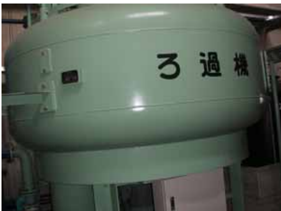
写真 - 8 屋内に設置されたるろ過機
