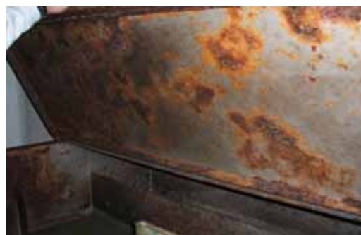
写真 5 汚水計量槽蓋の腐食
