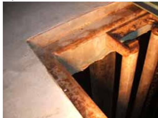
写真 4 原水ポンプガイドパイプの腐食
