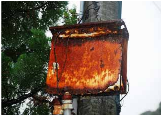
写真 - 6 屋外引込柱の装柱類の腐食
