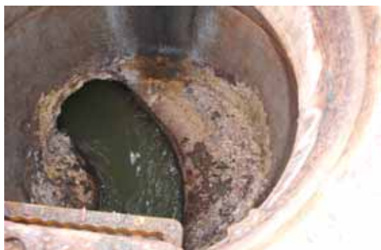
写真 1 微生物腐食を受けたマンホール
