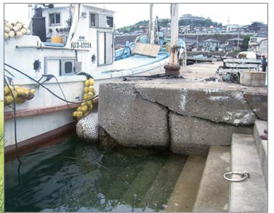
コンクリート構造物のひび割れ
