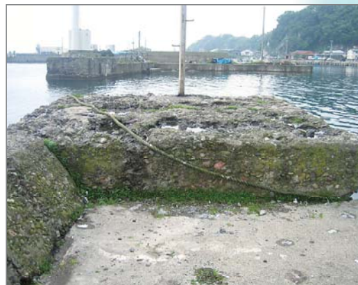
コンクリート構造物（上部工）の劣化
