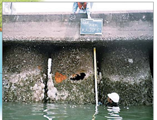
鋼構造物の腐食
