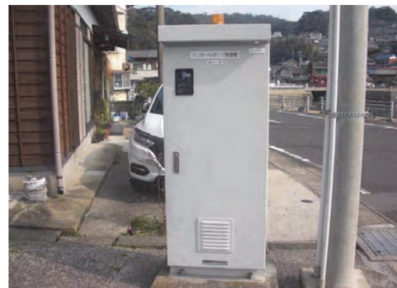
写真-6 中継ポンプ制御盤
