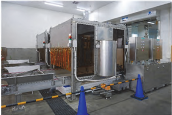
写真-4 1t タンク自動洗浄装置
