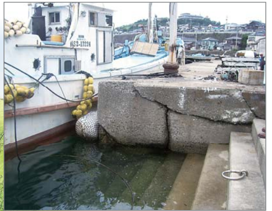
コンクリート構造物のひび割れ
