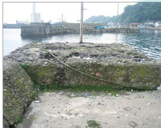
コンクリート構造物（上部工）の劣化
