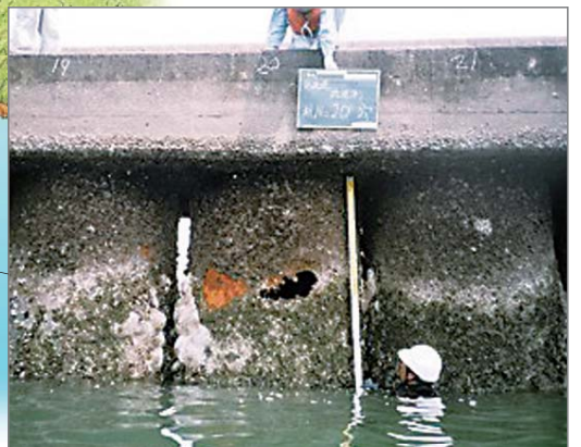
鋼構造物の腐食
