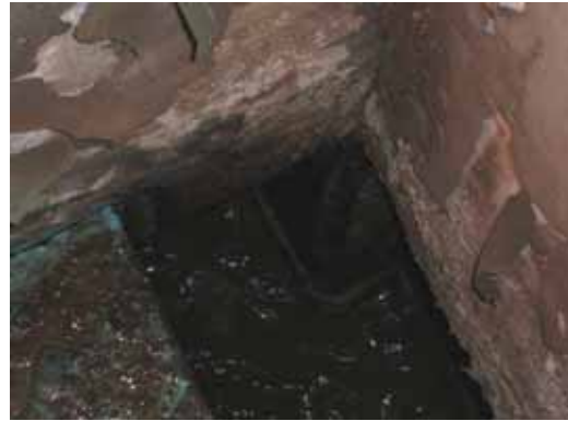
写真 3 水槽躯体ライニングの剥離 (流量調整槽)
