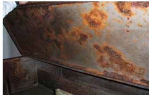
写真 5 汚水計量槽蓋の腐食
