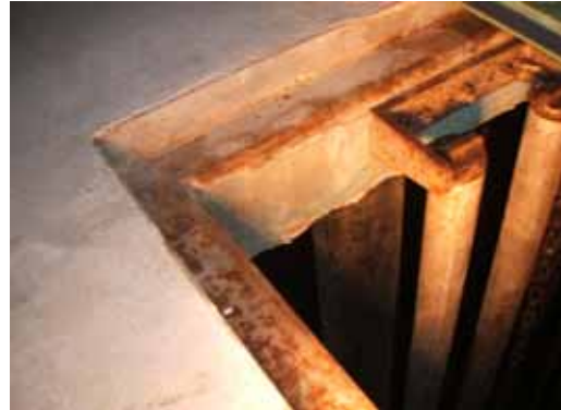
写真 4 原水ポンプガイドパイプの腐食
