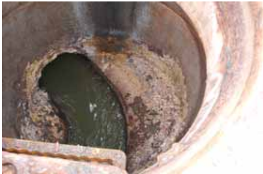
写真 1 微生物腐食を受けたマンホール
