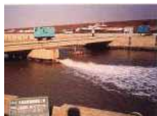
写真-1 ポンプ稼働状況
